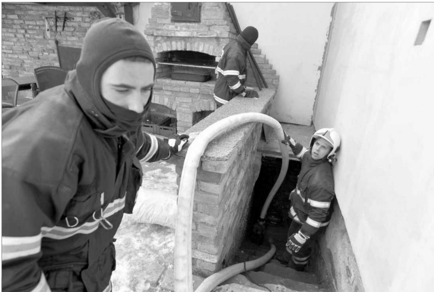
Hasiči včera odčerpávali vodu z prasklého potrubí v podzemních prostorách rodinného domu ve Valticích na Břeclavsku. Voda prostory zaplavila do výše dvou metrů. Není ale zatím jisté, zda událost souvisí s mrazem. FOTO – ČTK/Václav ŠÁLEK
